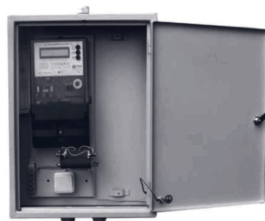
ШКАФЫ РАЗДЕЛЬНОГО УЧЁТА ЭЛЕКТРОЭНЕРГИИ
