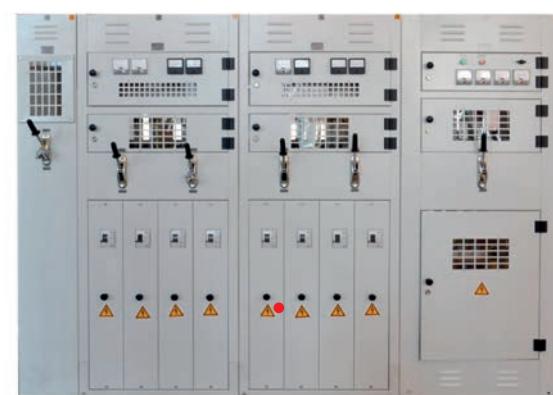
ПАНЕЛИ РАСПРЕДЕЛИТЕЛЬНЫХ ЩИТОВ ЩО-70-3
