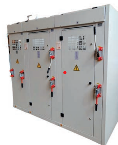
КАМЕРЫ СБОРНЫЕ ОДНОСТОРОННЕГО ОБСЛУЖИВАНИЯ ТИПА КСО
