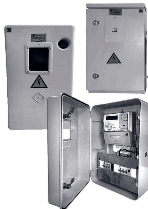
ЩИТКИ УЧЁТА ЭЛЕКТРОЭНЕРГИИ ВЫНОСНОГО ТИПА
